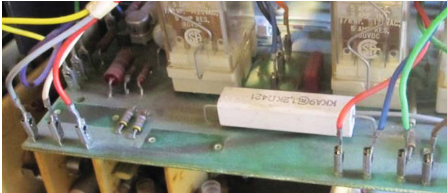
Bild 7: Die beiden Rifa-Kondensatoren (bereits entfernt) saßen vor einem Hochlast-Widerstand auf der Relais-Platine und konnten leicht ausgelötet werden.
