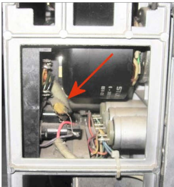
Bild 9: Unterhalb des Außenläufer-Motors saß der Stinker in direkter Nachbarschaft zu den Motoranlauf Kondensatoren.
